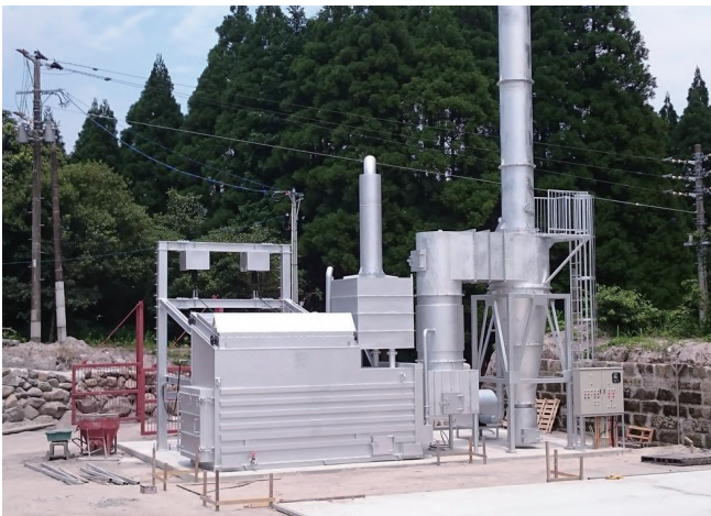
水冷式焼却炉
